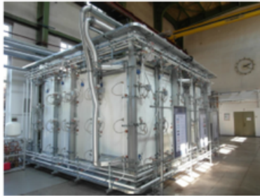
Abbildung 1: Klimaraum der TU Dresden
